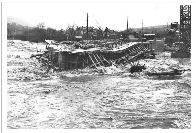
Samt Bewehrung zerstörte Schalung beim Neubau der Fink-Brücke in Hirschwang Hochwasser 1961
